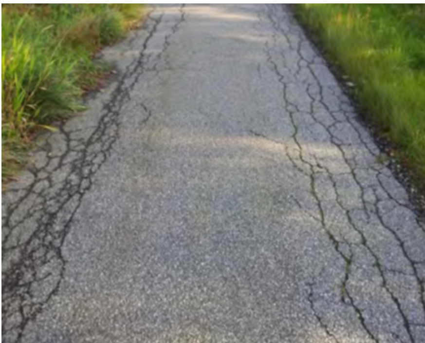
Oppsprukken gang- og sykkelveg. Foto: Eivind Stangeland, SVV
