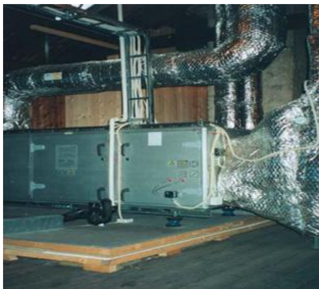
Foto: Ventilasjonsanlegg på loftet i en bygård. Kilde: Statens vegvesen 2008
